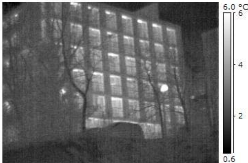
Bild 17 Außenthermografie des Gebäudes. An der Fassade sind keine Auffälligkeiten zu entdecken. Durch die Fassadenkonstruktion mit hinterlüfteten Faserzementplatten sind eventuelle Wärmebrücke jedoch von außen kaum sichtbar. Lediglich die Überströmöffnungen in den Fenstern des NEH treten im Infrarotbild hervor. Bild: b+tga
