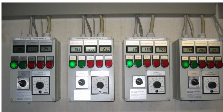
Bild 46 Fernbedienungselemente der Lüftungsregelungen im Technikraum des PH. Hier werden zentrale Betriebsparameter wie Lufttemperaturen und Störmeldungen angezeigt. Über ein Stellrad kann hier die Sollgröße für die Zulufttemperatur eingestellt werden.
