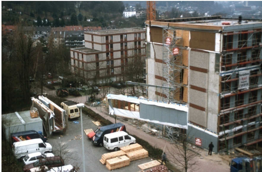
Bild 4 Die neue Fassade wurde aus vorgefertigten Holzleichtbauelementen an die Baustelle geliefert und dort montiert. Quelle: acms
