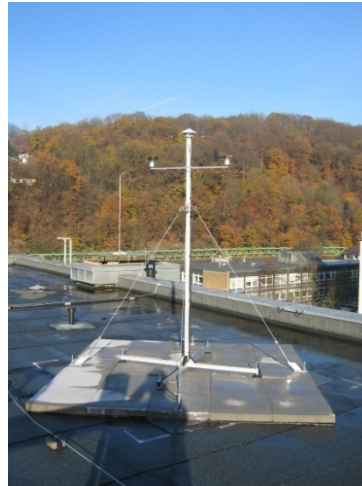
Bild 12 Wetterstation auf dem Gebäude HB am Campus Haspel. Im linken Bild zu sehen ist ein Pyranometer mit Schattenring zur Erfassung der Diffusstrahlung, links daneben das Wetter-schutzgehäuse für Temperatur- und Feuchtesensor, rechts daneben der Trichter zur Niederschlagsmessung. Das rechte Bild zeigt den Masten mit Windrichtungs- und Windgeschwindigkeitsmessung, sowie einem Pyranometer zur Erfassung der Globalstrahlung. Bild: b+tga
