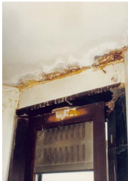
Bild 3 Schnitt durch die alte Fassade (links), sowie Bauschaden im Giebelbereich (rechtes Bild). Die undichte und unzureichend gedämmte Fassade führte zu hohem Heizwärmeverbrauch und durchfeuchtung ganzer Fassadenteile. Bild: acms
